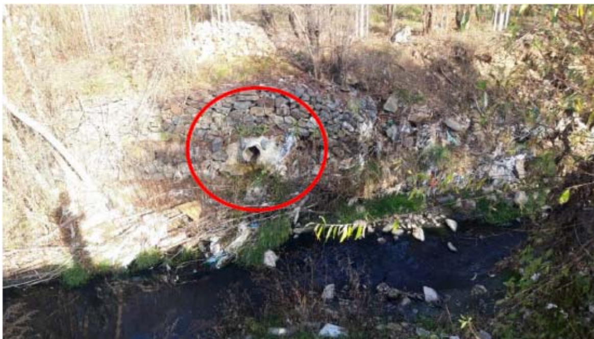
Slika 7: primer izvedenog izliva kanalizacije direktno u vodotok.
